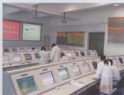
先进的网络监控机房。
